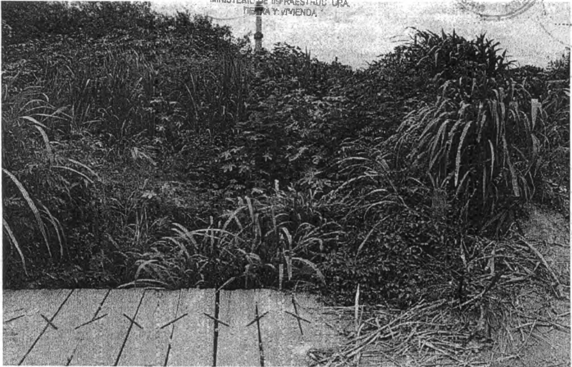
Fotografía 7: Canal Mitre a la altura de calle Hna. Justina Lleyra, se evidencia importante vegetación y falta de mejora de la sección del mismo.
